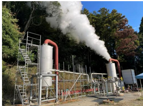
噴気試験中の地上設備
