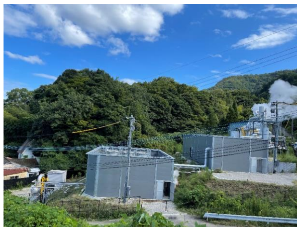
完成した2つの地熱バイナリー発電所(防音壁を設置)
