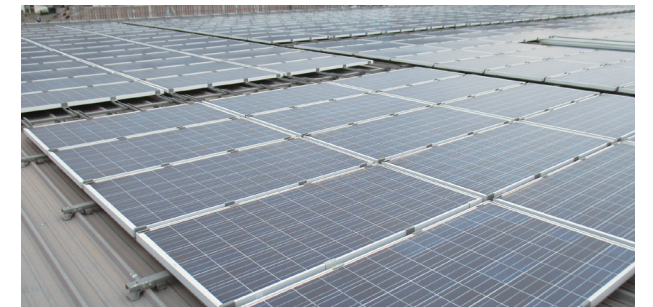
ルーフトップ太陽光発電システム
