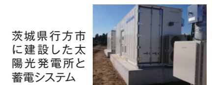
茨城県行方市に建設した太陽光発電所と蓄電システム【画像協力：BLD Power Stations株式会社】
