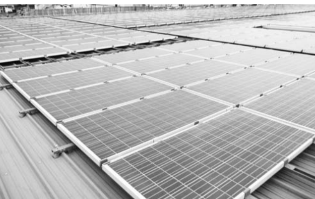
ルーフトップ型の太陽光発電システム
